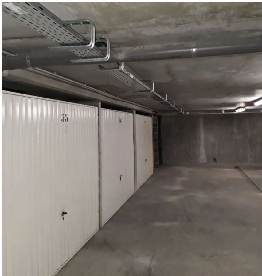
Colonne électrique horizontale et conducteur de terre en chemin de câble
