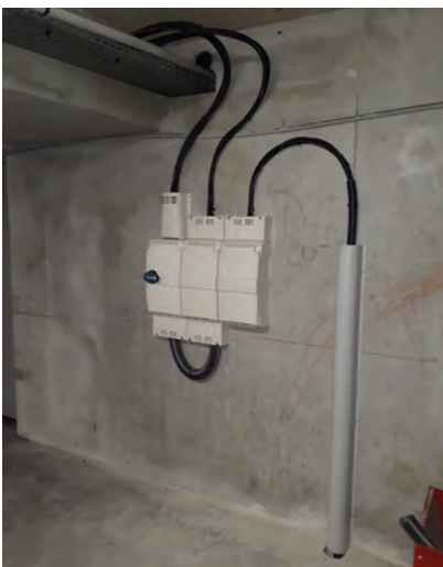
Interrupteur pompier et coffret de répartition pour desservir 2 niveaux de parking
